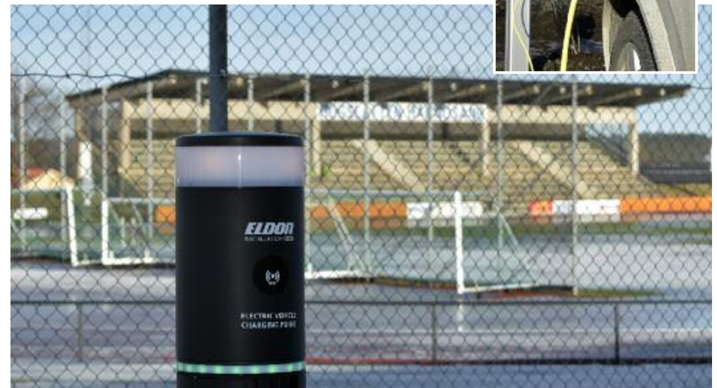
Laddstolpar för elbilar har installerats på bl a idrottsanläggningarna Högsletten och Simhallen samt vid Härnösand Central.
